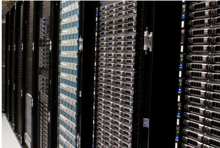
Une allée de routeurs dans un centre de données
